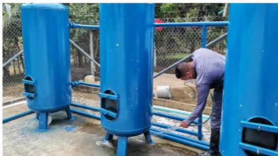
Ilustración N° 123. Mantenimiento preventivo PTAP (11/2025)
